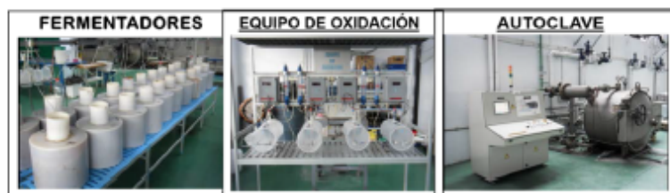
Figura 3. Equipos con los que se realizaron las experiencias a nivel de planta piloto en el Instituto de la Grasa
