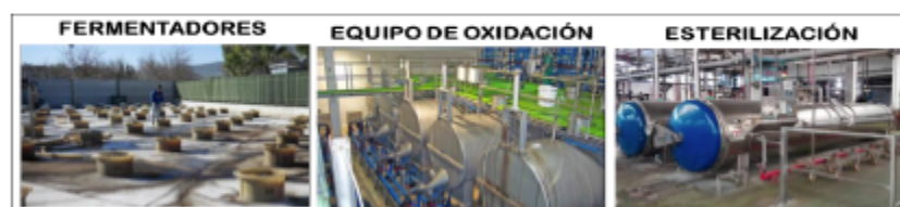
Figura 5. Instalaciones en las que se realizaron las experiencias a nivel industrial
